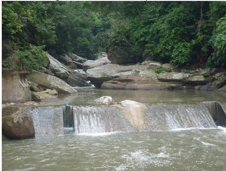
Imagen N° 44: Vista de la captación Shima
