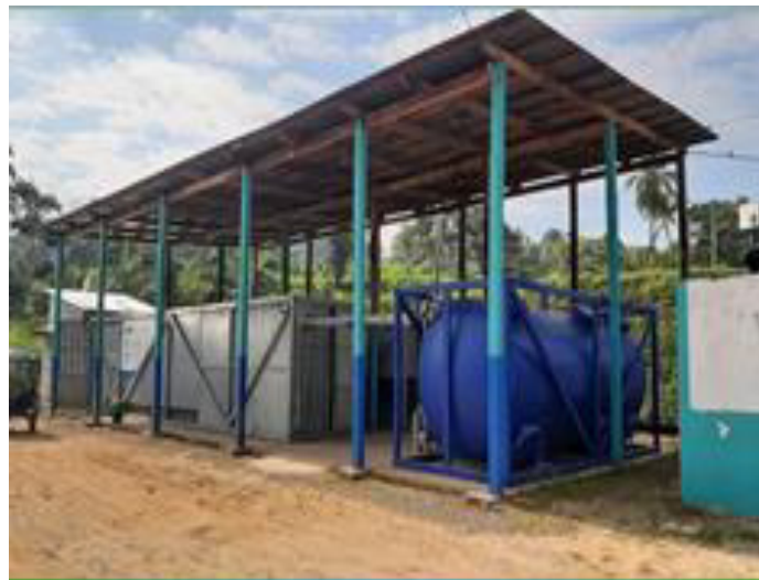
Imagen N° 33: Vista de la PTAP Cumbaza
