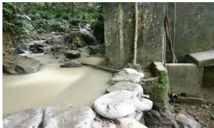
Imagen N° 5: Riesgo de contaminación en captación
