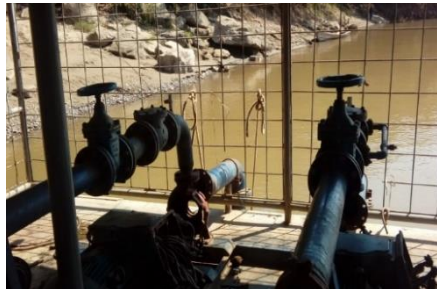
Imagen N° 13: Bombas y válvulas deterioradas
