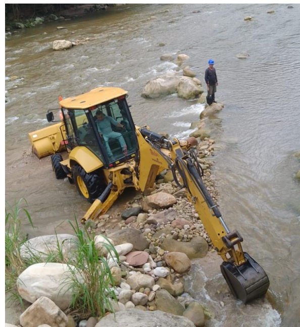
Imagen N° 7: Desarenamiento de la Captación Cumbaza
