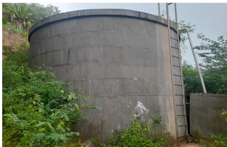
Imagen N° 83: Reservorios de 80 m3 y caseta de válvulas
