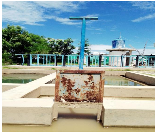
Imagen N° 78: Compuertas en mal estado
