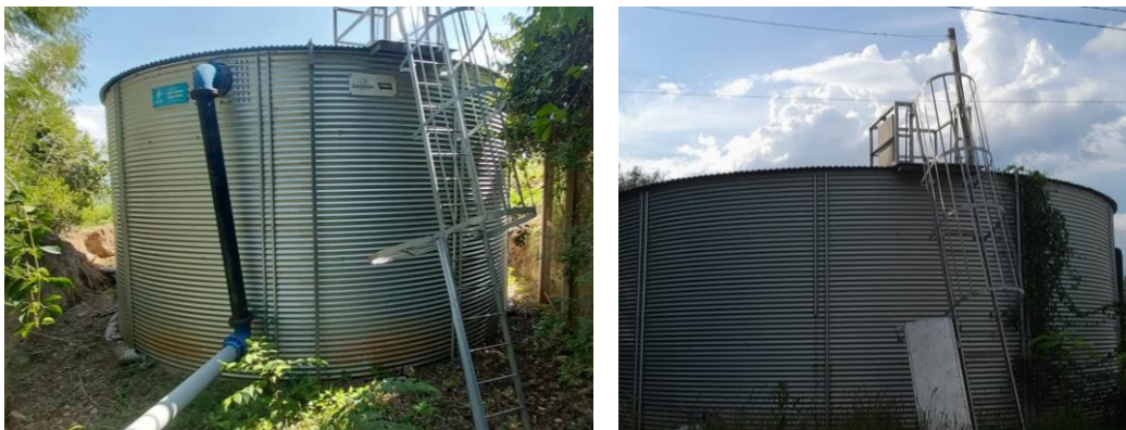
Imagen N° 86: Reservorios de 250 m3 portátiles
