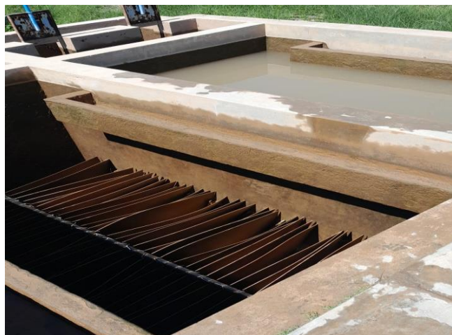
Imagen N° 79: Vista de decantadores deficientes
