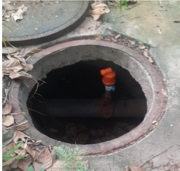
Imagen N° 82: Válvulas de purga de aire
