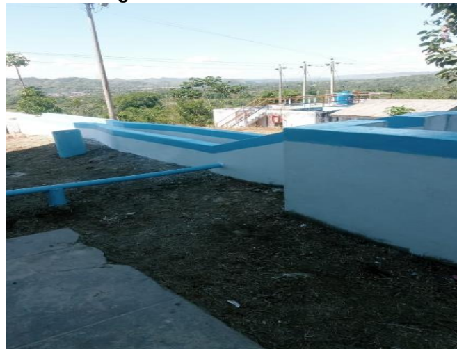
Imagen N° 47: Vista del canal Parshall
