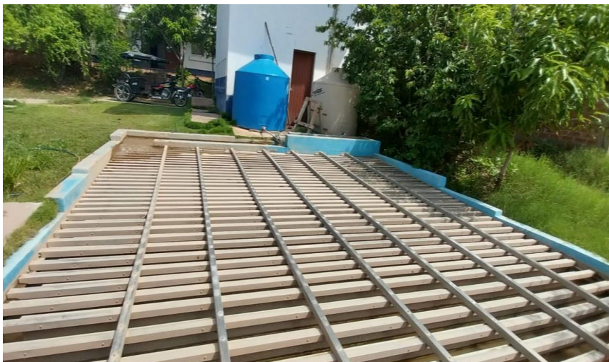
Imagen N° 77: Vista de los floculadores horizontales
