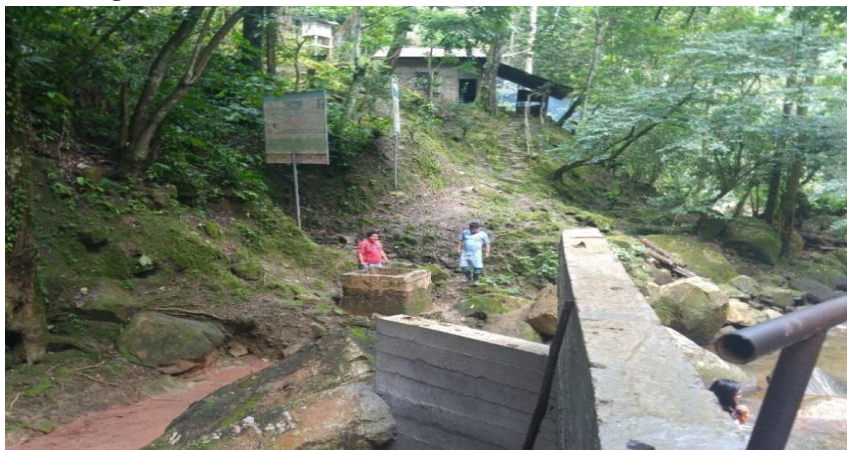
Imagen N° 18: Vista de la cámara de válvula de control
