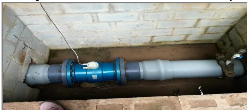
Imagen N° 25: Vista de la línea de conducción de Shilcayo
