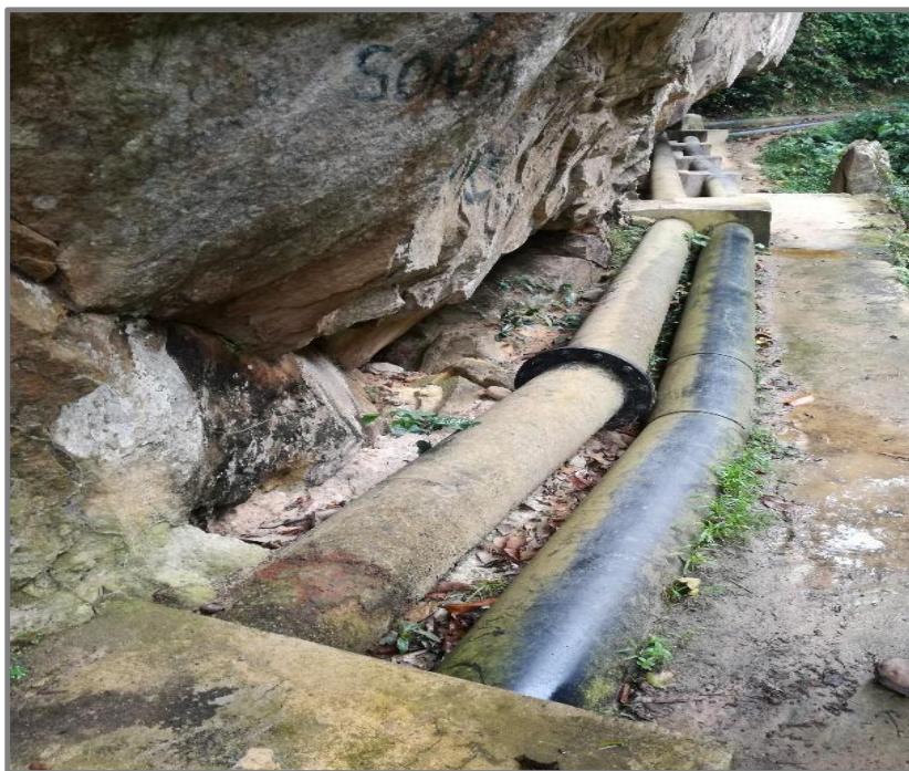
Imagen N° 26: Vista de la línea de conducción de Ahuashiyacu
