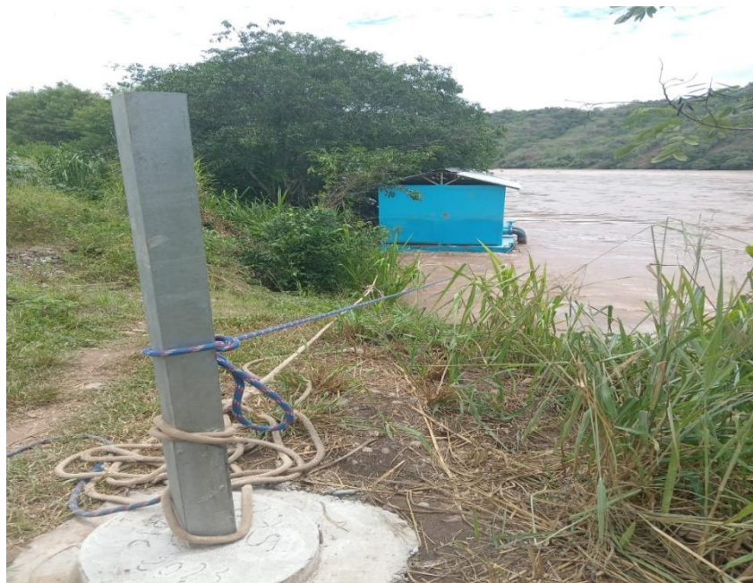
Imagen N° 65: Captación PTAP Río Huallaga
