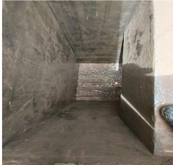
Imagen N° 80: Vista de filtros deficientes
